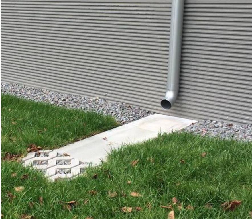
Figur 5-2. Exempelbild på stuprör med utkastare.
