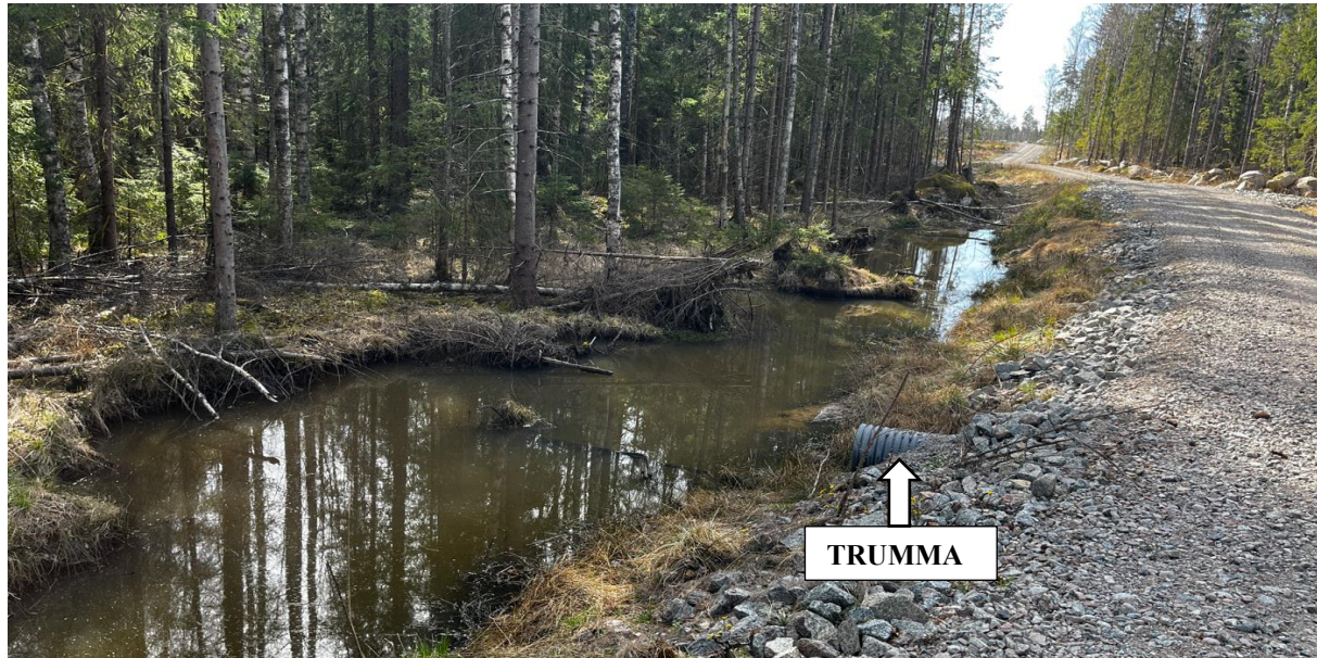
Figur 4.7. Stående vatten finns längs med den nylagda grusade vägen söder om detaljplanen.
